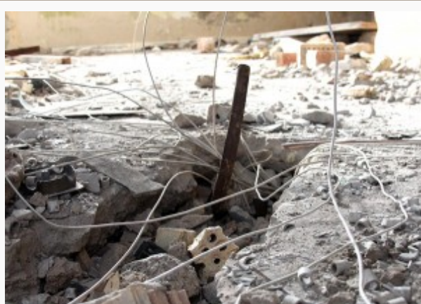
Sterczące kable i końcówki — przewodów — to, co złodziejom metalu nie udało się wydrzeć z betonowych ścian schronu łącznościowców Fot. Marian Paluszkiewicz
